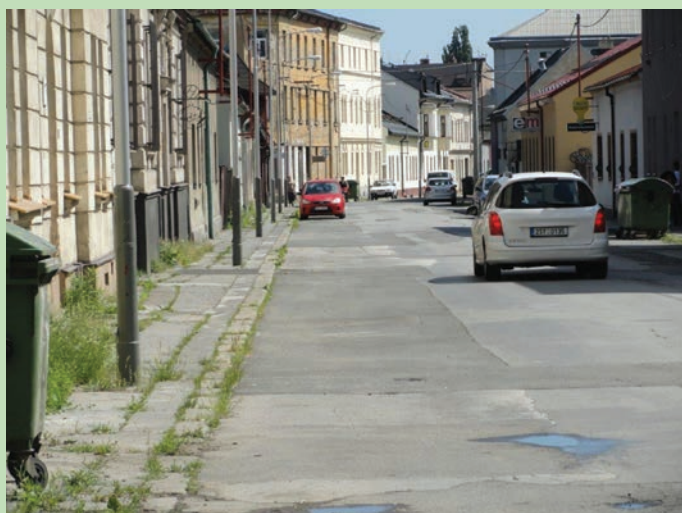
Chodník v Erbenově ulici před opravou...
